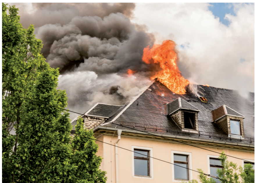
Gebäudebrände werden immer wieder durch Dacharbeiten verursacht.
